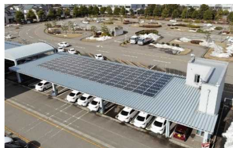
AOIドライビングスクール福井校に設置された太陽光発電設備
