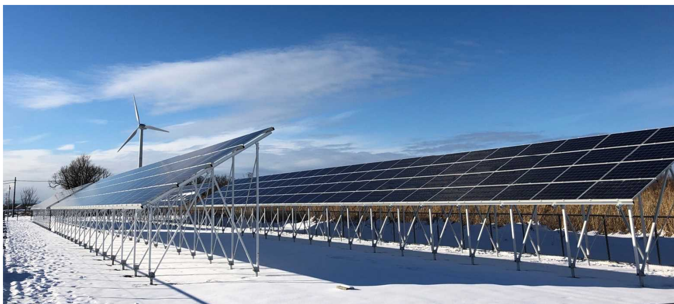
【ハイブリッド発電所】北海道石狩市
